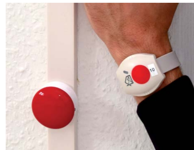
Nothilfe: Wenn ein Bewohner Hilfe braucht, muss der Hilferuf schnell und unkompliziert erfolgen. Die Notruftaster können in der Wohnung fest installiert oder am Handgelenk getragen werden.
